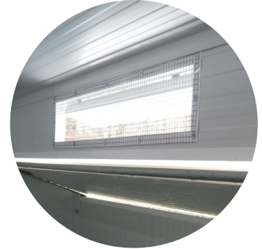
Seiten Lüftungen mit schneller Öffnung L 95cm x h 18 cm
